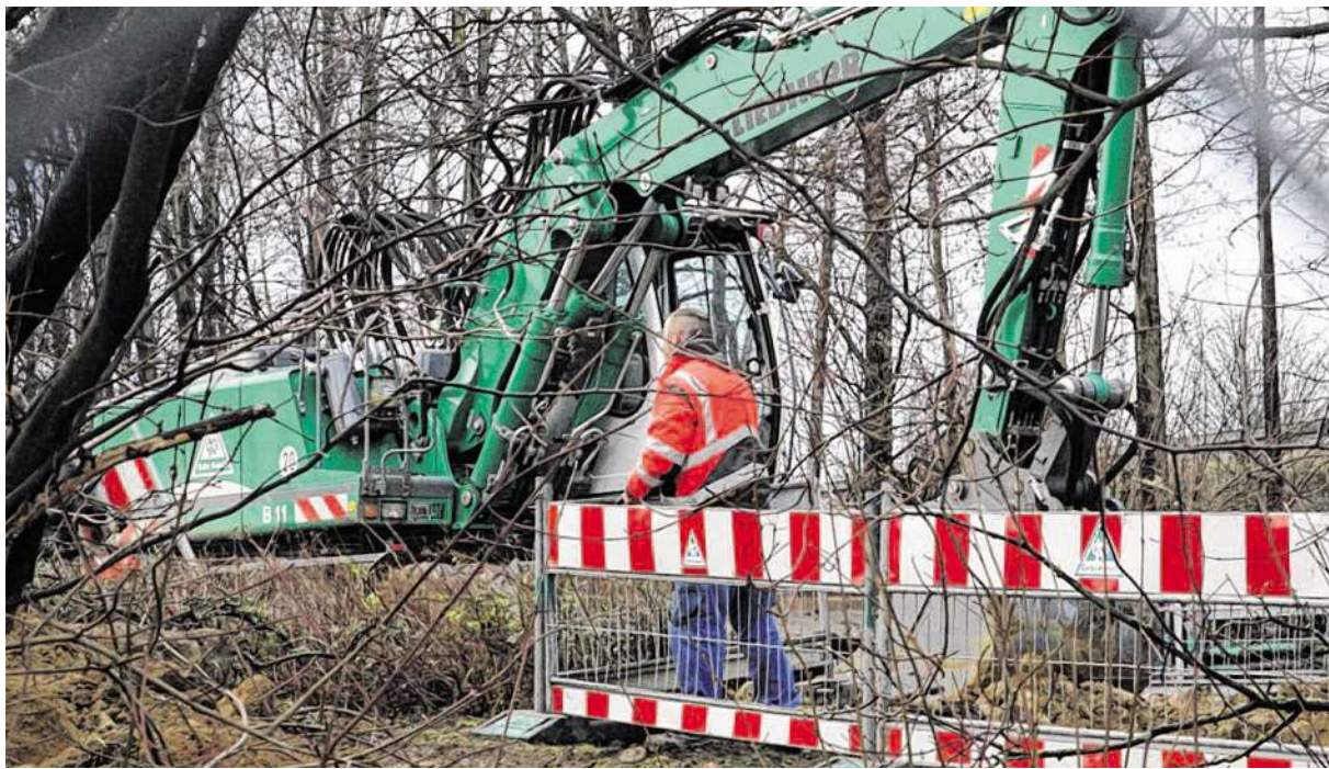
Sanierungsarbeiten auf dem Aseag-Betriebsgelände: Nach dem Dieselunfall kurz vor Weihnachten musste auch über die Festtage hinweg verseuchter Untergrund abgetragen werden. Foto: Ralf Roeger
