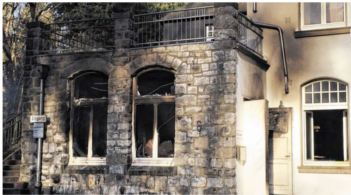
Der Anbau, in dem die Schreinerei der Jugendberufshilfe untergebracht war, wurde durch das Feuer schwer in Mitleidenschaft gezogen. Foto: Stadt Aachen
